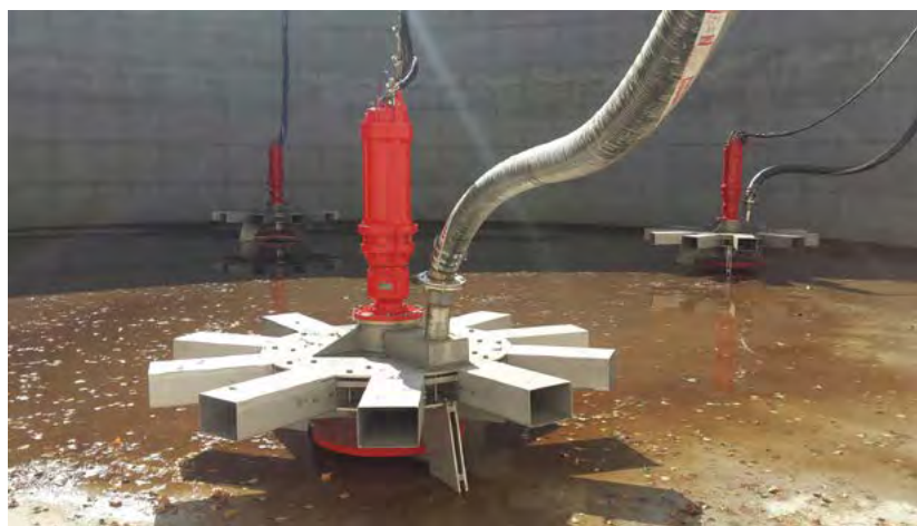
Figura 5. SCLK impianto cantina / distilleria.
