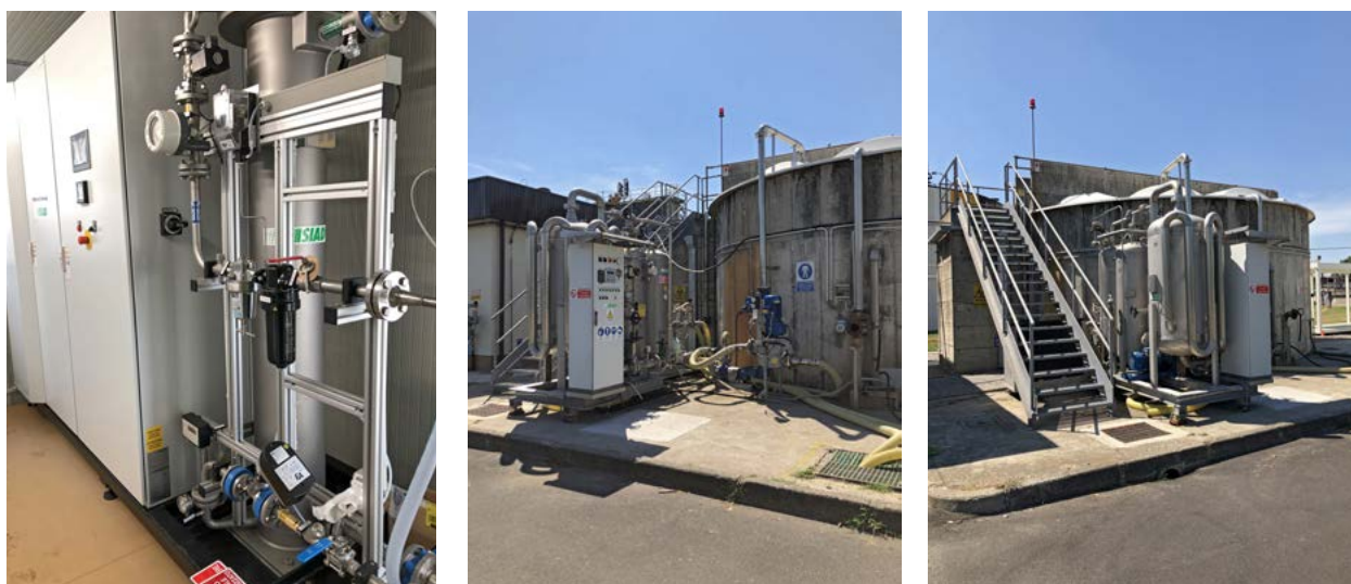
Figura 2. Immagini dell'impianto pilota di ozonolisi per il trattamento di fango pre-ispessito. Da sinistra: generatore ozono, vista frontale del reattore di contatto integrato al pre-ispessitore, vista dal retro del reattore stesso.
