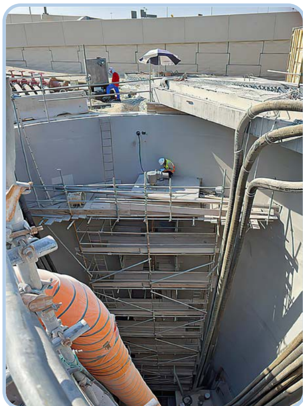
Figura 2. Posizionamento e verifica degli attuatori nella camera sotterranea per la raccolta delle acque.
