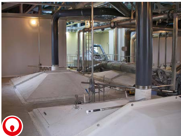
Figura 2. Foto degli MBBR coperti. Fonte. La gestione degli impianti di depurazione MBBR, Maggioli Editore, 2021
