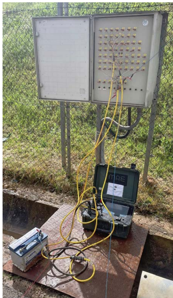
Figura 3. Acquisizione dati da quadro di controllo.
