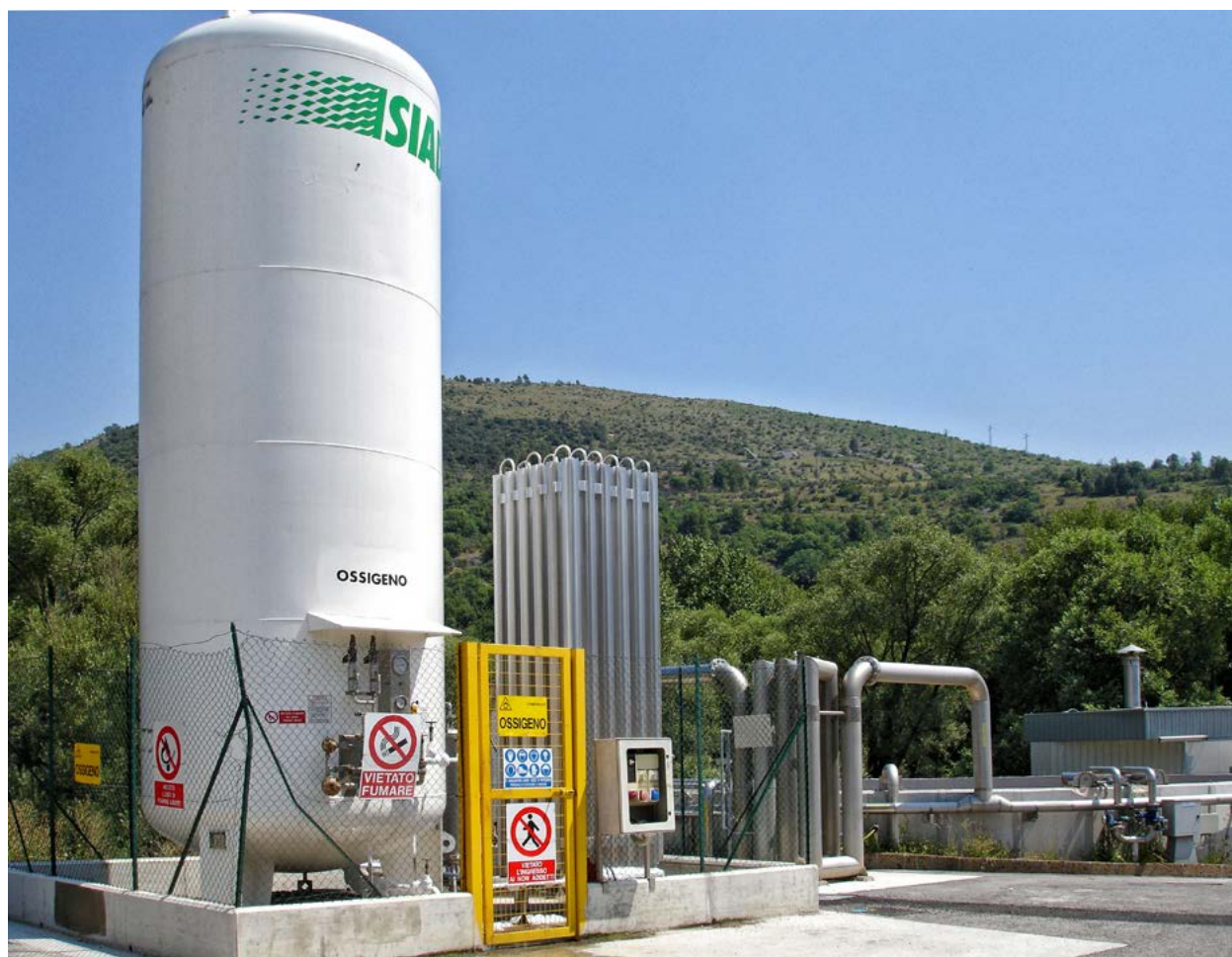
Figura 14. Impianto di stoccaggio, evaporazione e trasferimento dell'ossigeno nel processo di depurazione.
