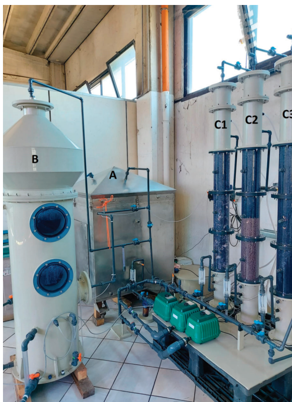
Figura 1 – Impianto pilota oggetto di studio (A biocella; B scrubber; C1 biofiltro in cippato di legno; C2 biofiltro in lava rock + torba; C3 biofiltro in torba)
